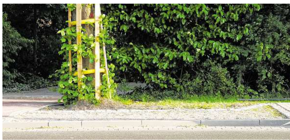
An der Heidberger Straße wird gerade der Gehweg neu gemacht. Anwohner sagen, dass es rund um die Bäume mit dem lockeren Splitt und hochstehenden Natursteineinfassungen so nicht bleiben kann. Soll es auch nicht, sagt das beauftragte Ingenieurbüro. FOTO: LUTZ RODE
